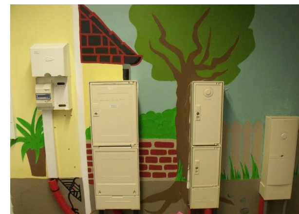
Distribution Basse tension
